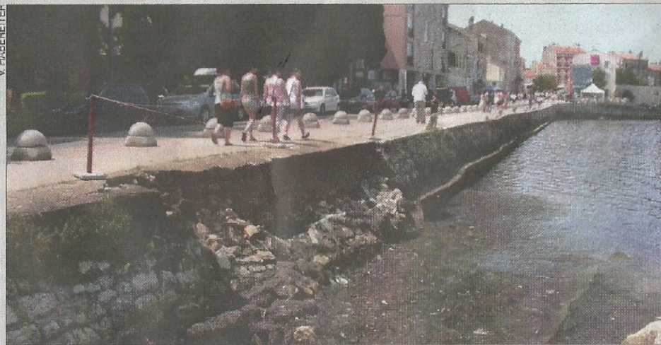
Urušeni dio obalnog zida na Peškero čeka da ga netko nadležan "primijeti"
